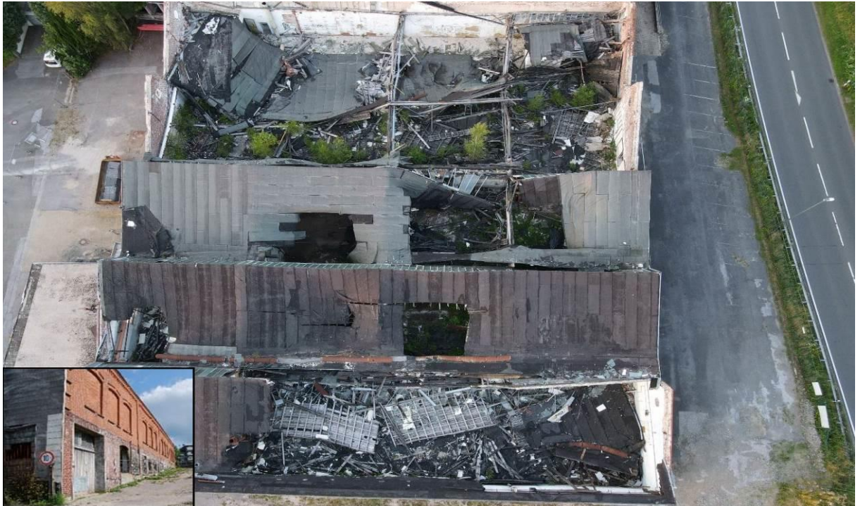
Bild 3: Blick auf den überwiegend verfallenen Gebäudebestand des Rhombus Areals im westlichen Teil des Plangebietes. Am rechten Bildrand der Verlauf der B 51 (Dellmannstraße). Verkleinerter Bildausschnitt unten links: Westliche Stirnseite des Gebäudeblocks.
