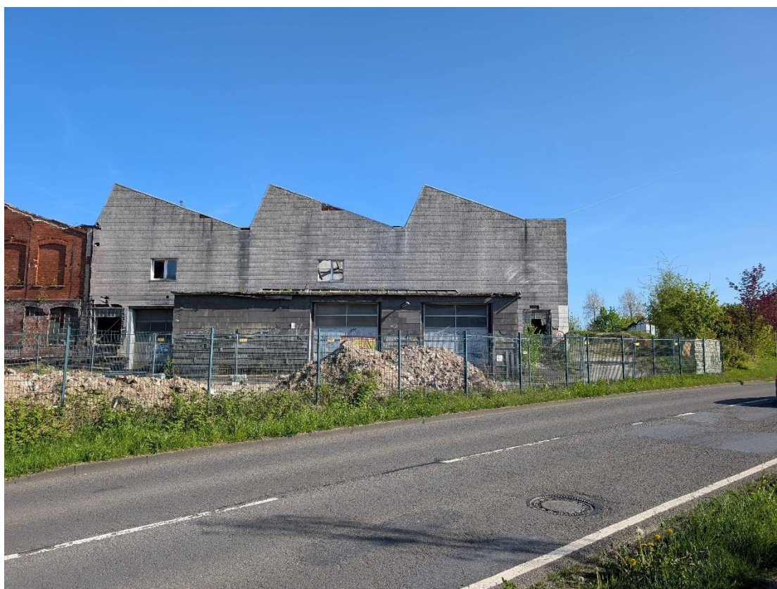
Bild 10: Gebäudeteile im Westen Wolfhagener Straße mit vorgelagerten Halden aus Ziegelschutt
