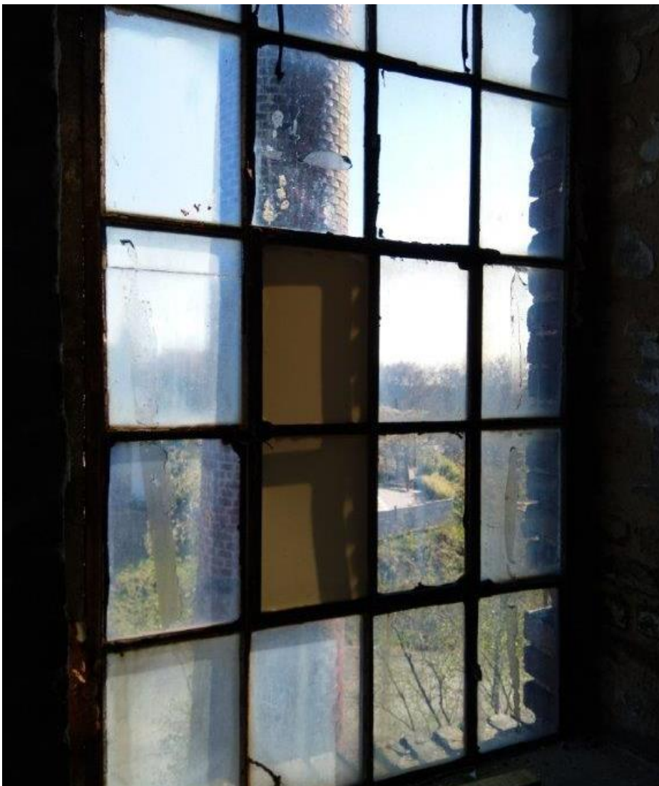
Große Einflugöffnung eines beschädigten Fensters wurde verschlossen.
