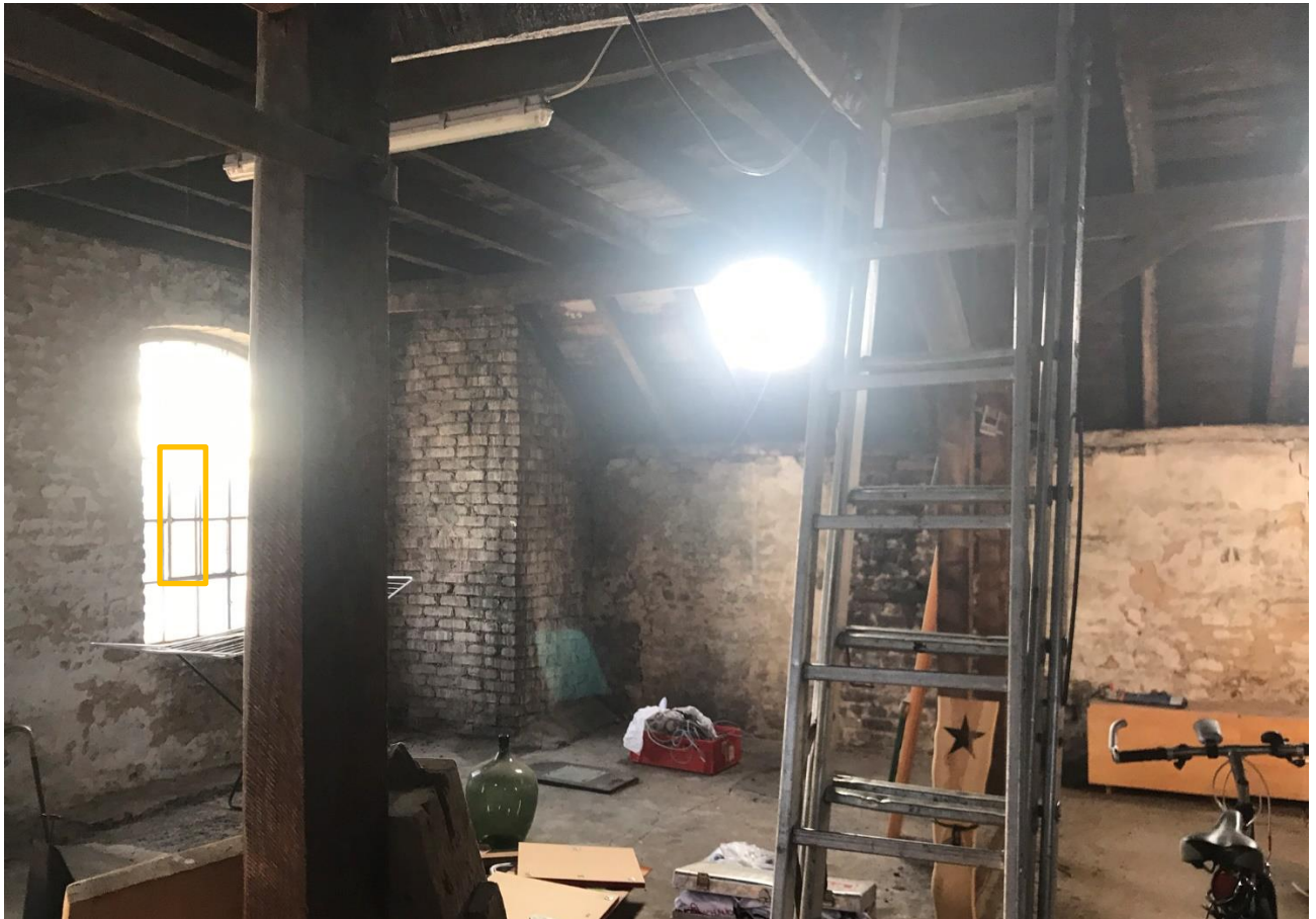
Foto 6 Raum des Obergeschosses mit defektem Fenster links.
