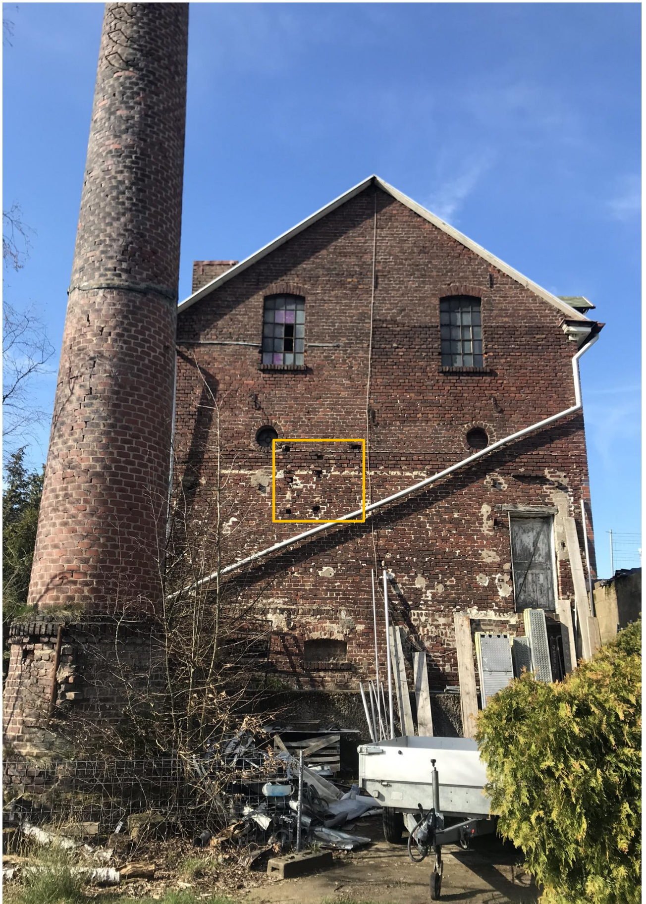
Foto 5 Blick auf die südliche Fassade: Mehrere kleine Nischen in der Fassade, Das Fenster ist defekt.
